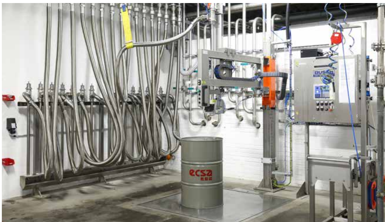
Sistema di riempimento solventi
